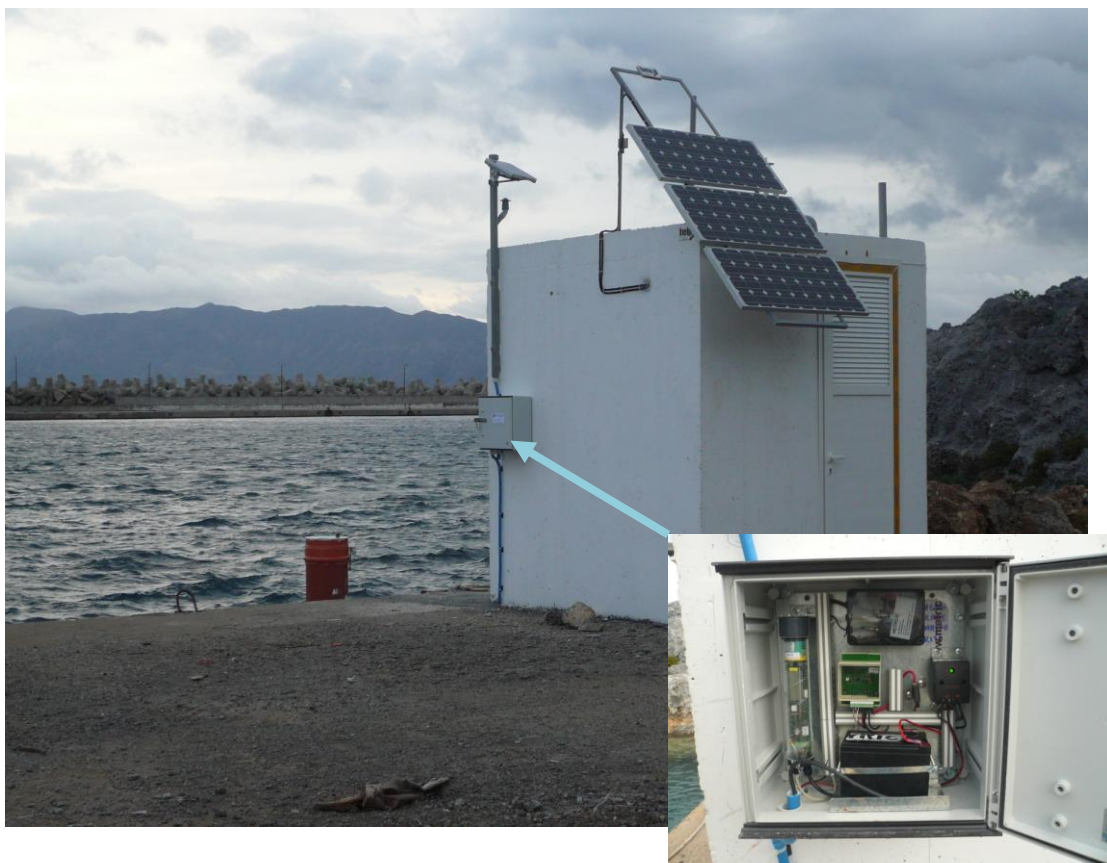
Εικόνα 1. Ο παλιρροιογράφος Thalimedes σε λειτουργία με τον ηλιακό συλλέκτη Λεπτομέρεια: Η καταγραφική μονάδα, το modem, οι 2 μετασχηματιστές και η μπαταρία
