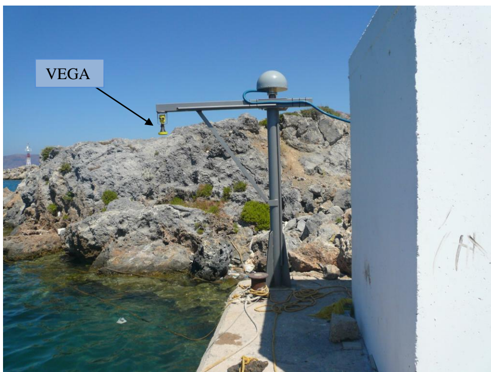
Εικόνα 2. Ολοκληρωμένο σύστημα καταγραφής ραντάρ (VEGAPULS)
